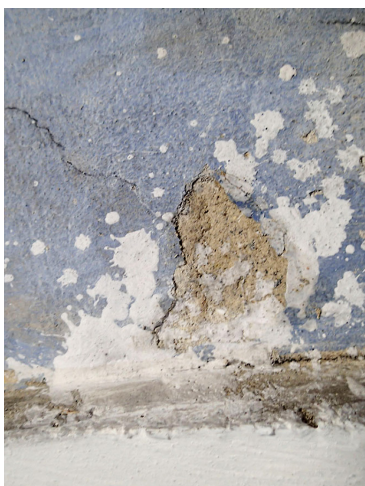
Detail loser und fehlender Putzpartien mit Kalkspritzern in der Randpartie des Tonnengemäldes.
