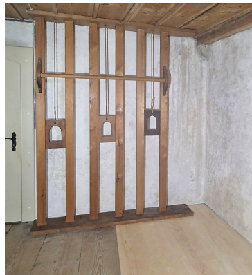
Wandpartie im Bereich der Kalkantenanlage vor der Restaurierung. Die infolge eines früheren Wassereintritts zerstörte Bodenpartie ist bereits ersetzt.
