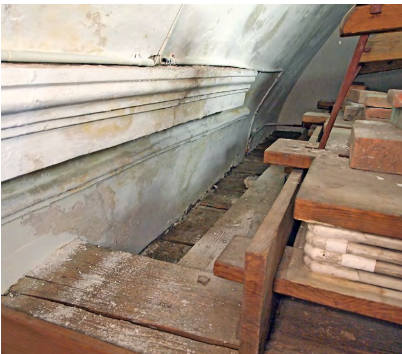
Blick in Gewölbepartie über der Balganlage mit Wasserschaden vor der Sanierung.
