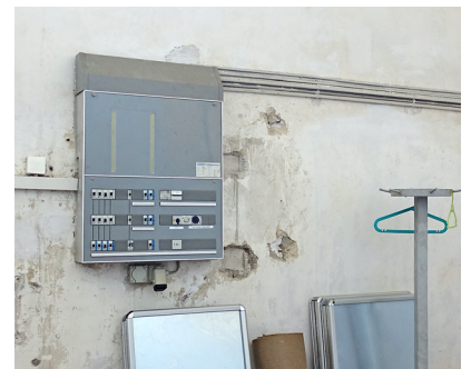
Heutiges Elektrotabelleau mit Zu- und Wegleitungen an der Nordwand des Bibliothek-Nebenraumes.
