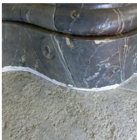
Schaden an einem Altarsockel infolge Feuchtreinigung.
